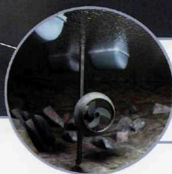
Мешалки, установленные на плоту, для формирования потока жидкости
