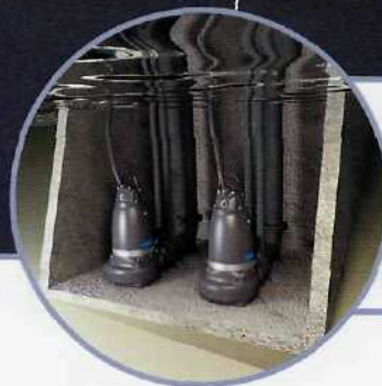
Заборная станция сырой воды для рыбопитомника и рыбоперерабатывающей установки
