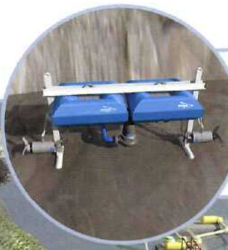
Откачка шлама из хранилища, предназначенного для аварийных ситуаций
